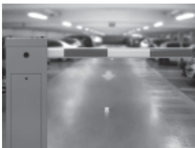
Шлагбаум, управляемый ПЧ ATV 12
